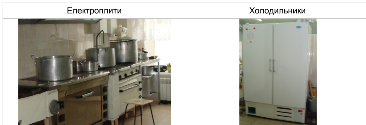
Рисунок 5.4.2.1 Вигляд електрообладнання в кухні
