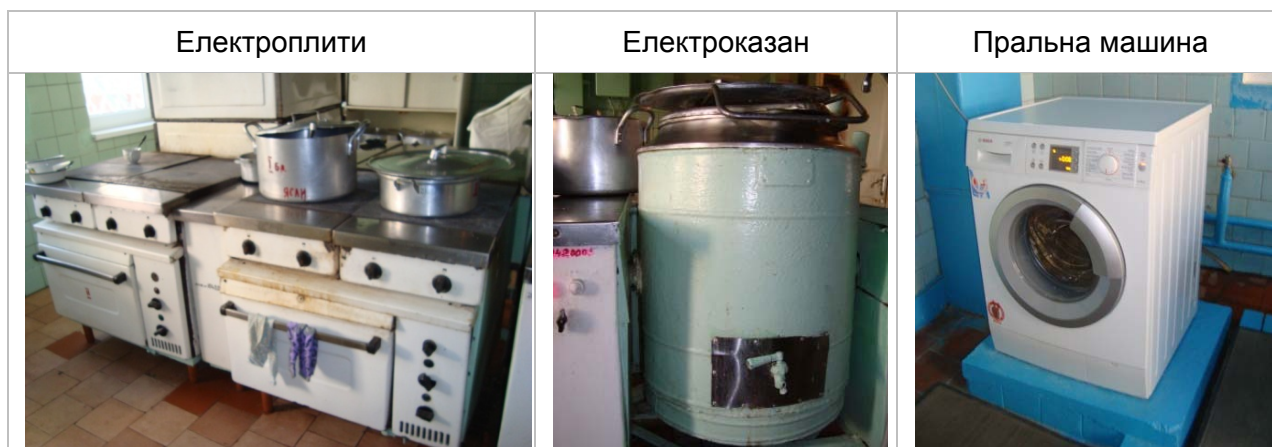
Рисунок 5.4.2.1. Вигляд електрообладнання в кухні та пральні
