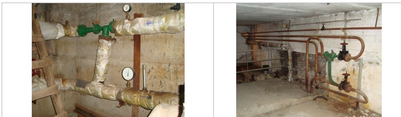
Рисунок 5.1.1. Елеваторні вузли та магістральні трубопроводи
