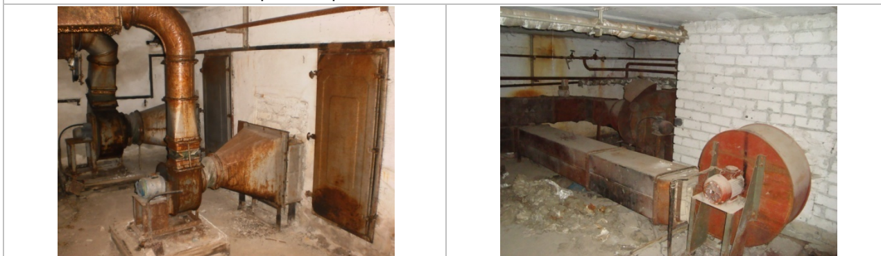
Вентагрегати припливної вентиляції в підвалі поліклініки
