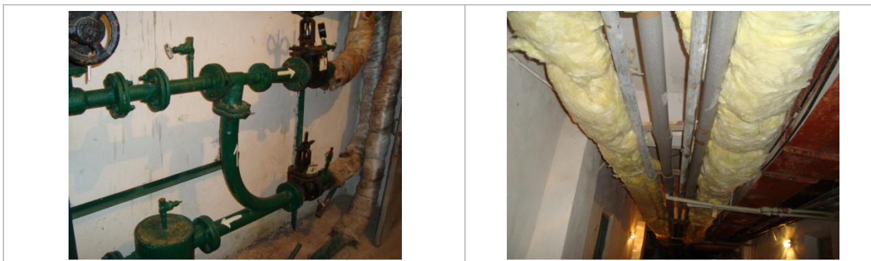
Рисунок 5.1.1. Елеваторний вузол та магістральні трубопроводи
