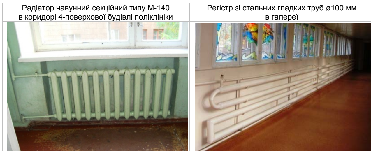
Рисунок 5.1.2. Прилади опалення будівлі, що встановлені в закладі
