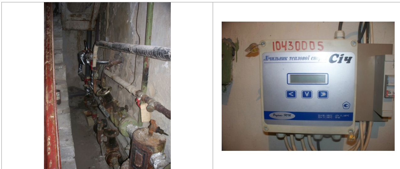
Рисунок 5.1.2. Прилади опалення будівлі
